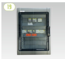
19 Rozvaděč nouzového napájení 1fázový
